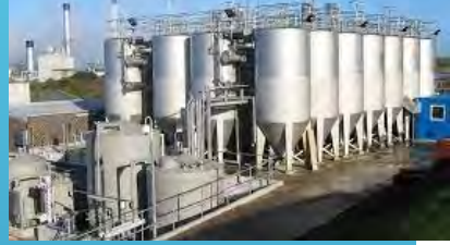
FILTROS DE ARENA
