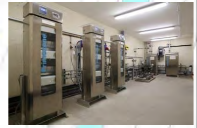
EQUIPO DE GENERACION DE OZONO
