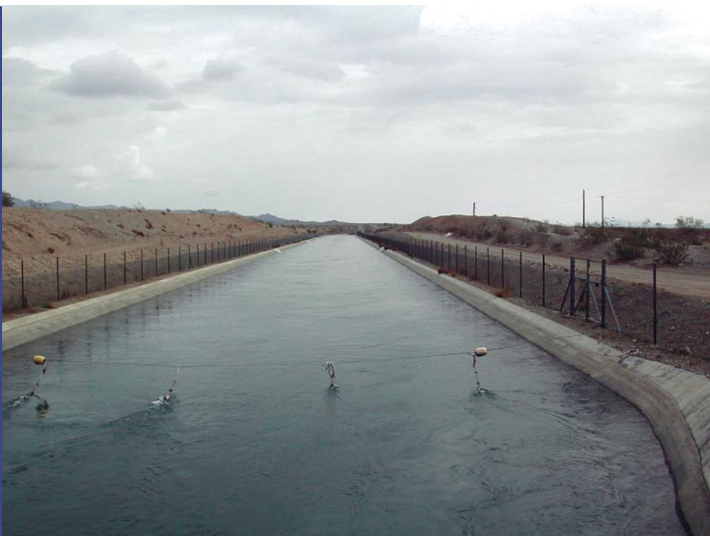
Acueducto de aportación de aguas desde el río Colorado, con un caudal de 1 hm 3 /día.
