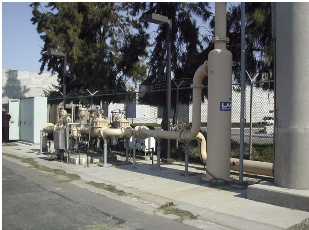
Pozo de inyección superficial de la barrera contra la intrusión salina
